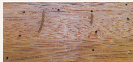
„Pinholes“ bei überseeischen Harthölzern
