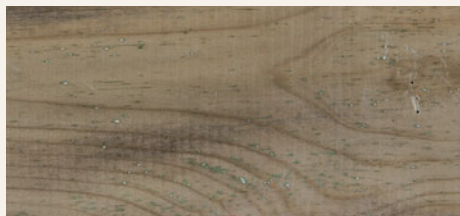
Umweltkeime, Stockflecken und leichter Schimmelbefall
