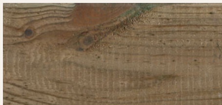
Raue Stellen auf der Holzoberfläche
